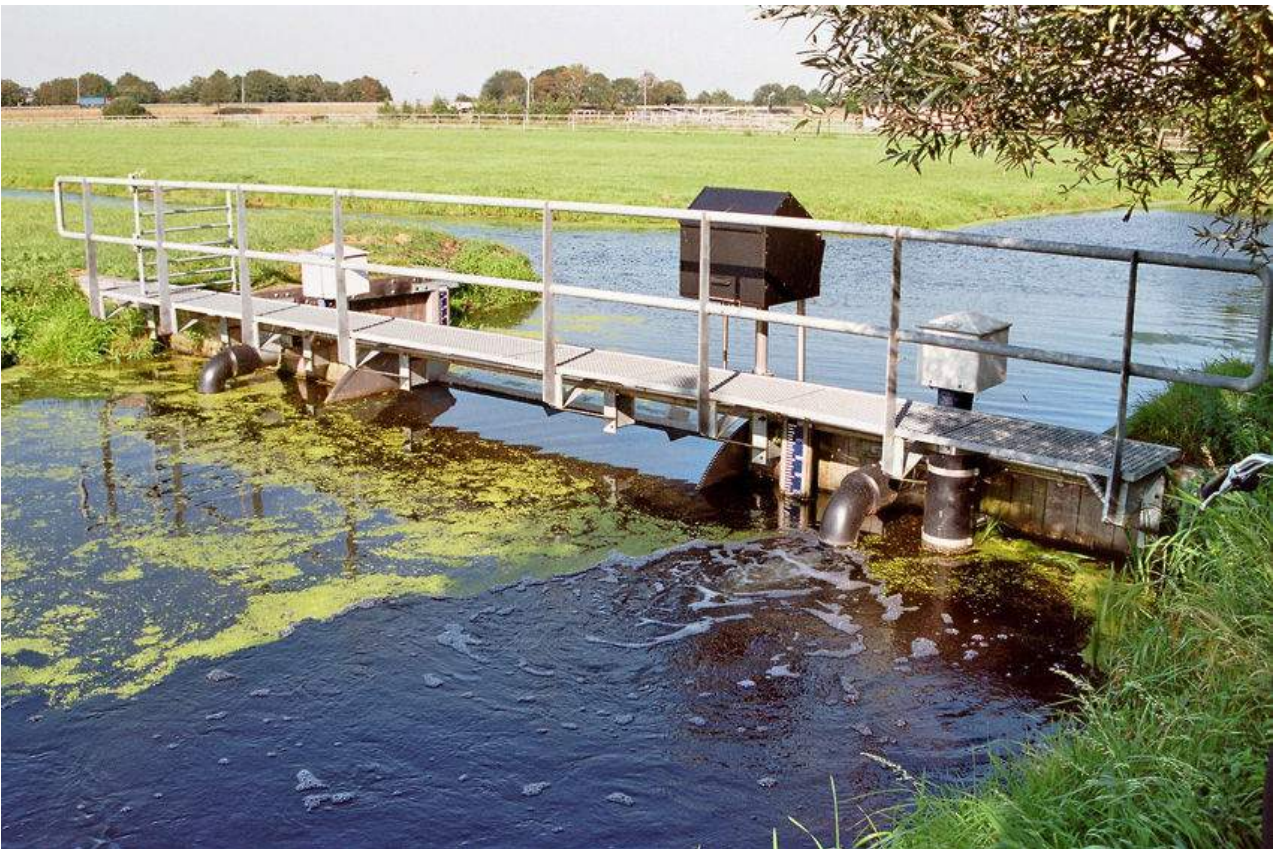
Figuur 58: Ontwatering langs het Oosteinde
