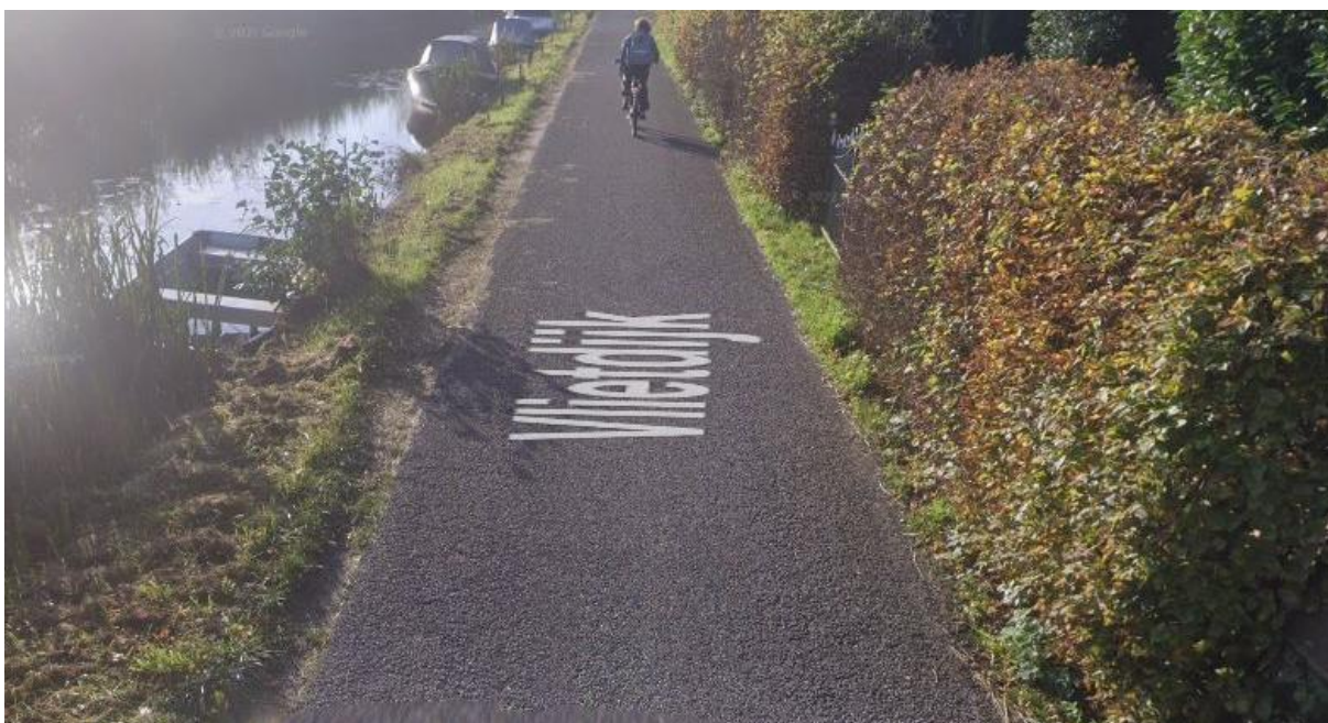
Foto – Schade als gevolg van onvoldoende wegbreedte en onvoldoende uitwijkmogelijkheid
