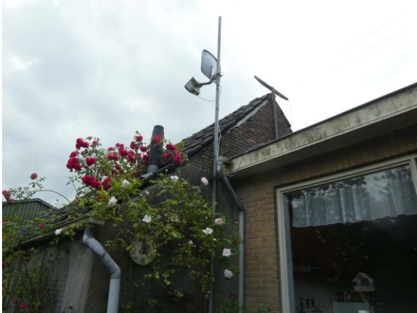
Figuur 8 Losse dakpannen op de schuur met Roos die door het dak groeit
