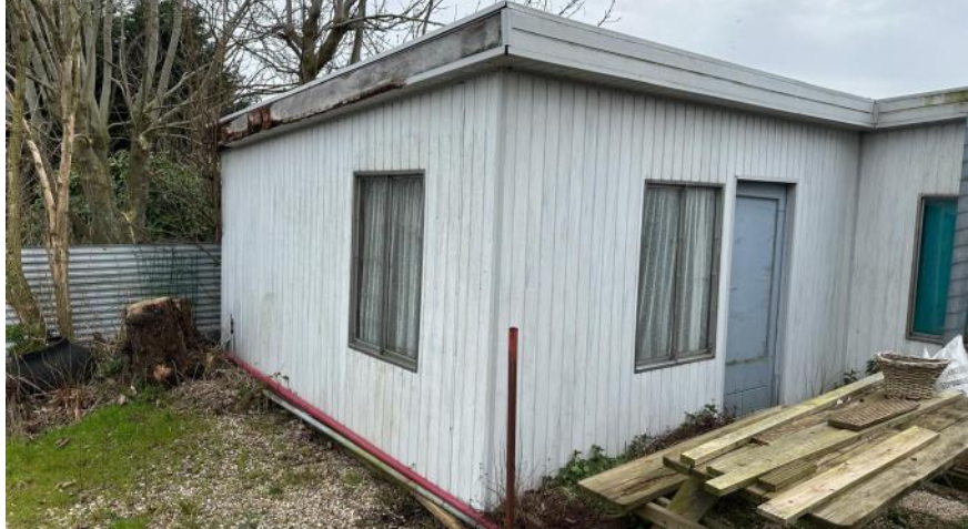
4. Diversiteit aan vervallen bouwwerken/recreatiewoningen op kavel
