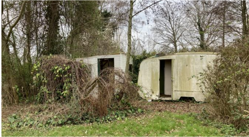
2. Diversiteit aan vervallen bouwwerken/recreatiewoningen op kavel
