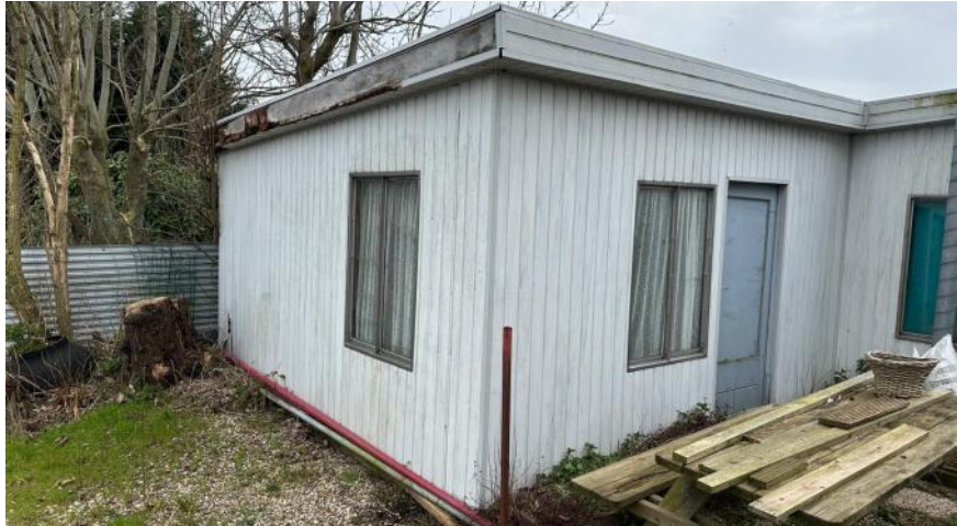
4. Diversiteit aan vervallen bouwwerken/recreatiewoningen op kavel
