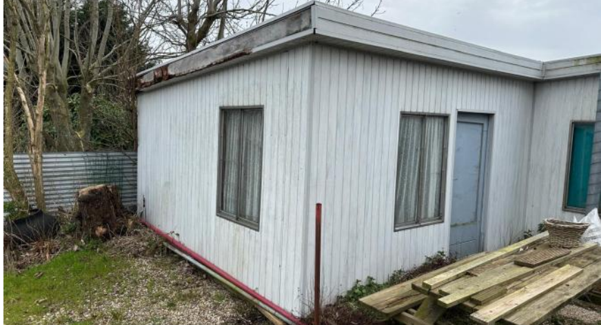
4. Diversiteit aan vervallen bouwwerken/recreatiewoningen op kavel
